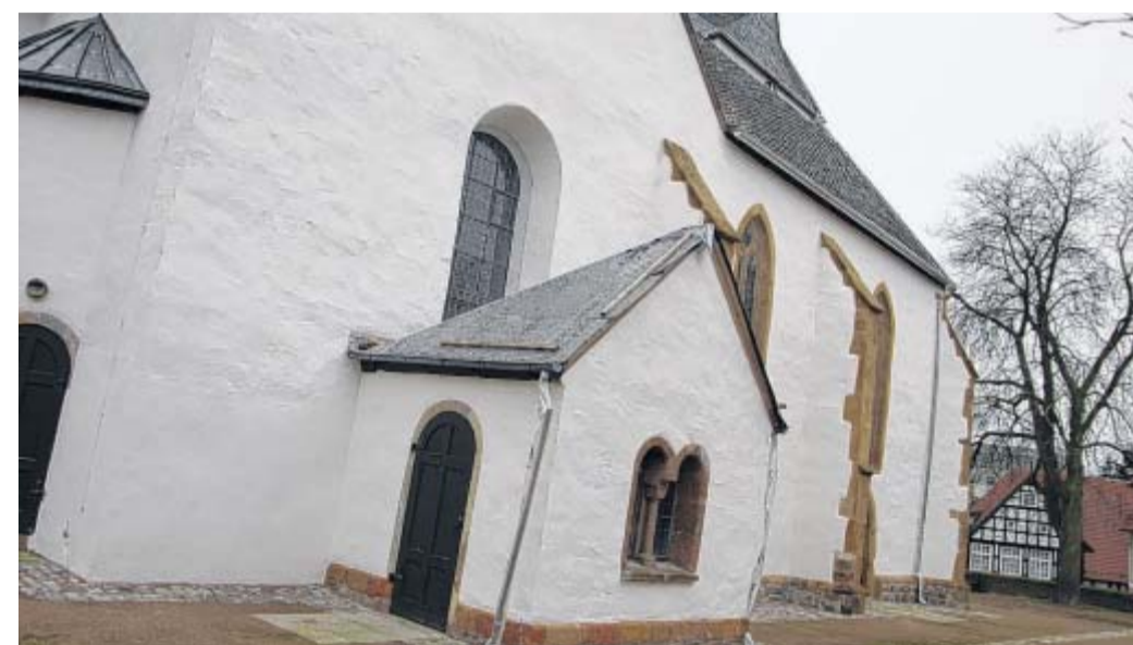
Feuchtigkeitsschäden beseitigt: Die Sanierung der Außenfassade ist gerade abgeschlossen, das älteste Gotteshaus in Bünde erstrahlt in neuem Glanz.
